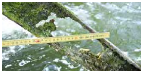
Durchgerostete Stahlstützen bei der Wehrkonstruktion
